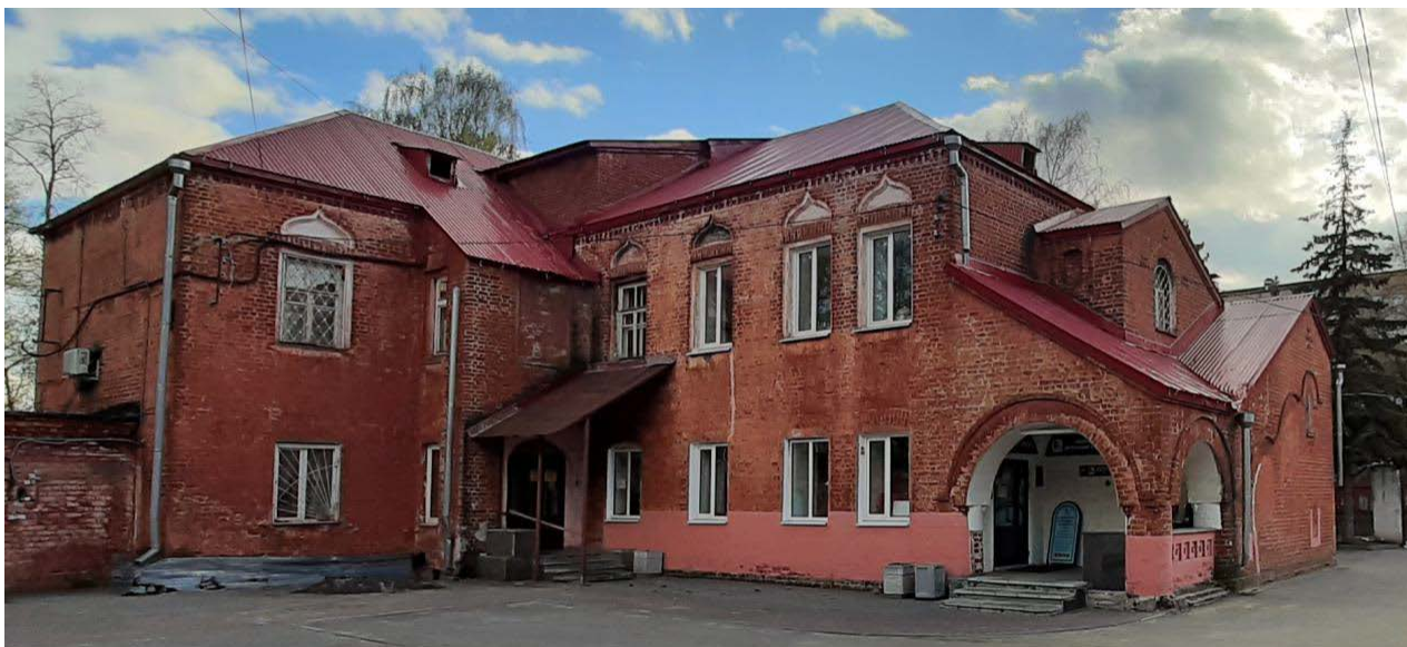
Общий вид дома причта Успенской церкви в составе ансамбля «Комплекс городского (нового) кладбища» г. Нижнего Новгорода. Вид с северо-востока. Фото 05.05.2021.
